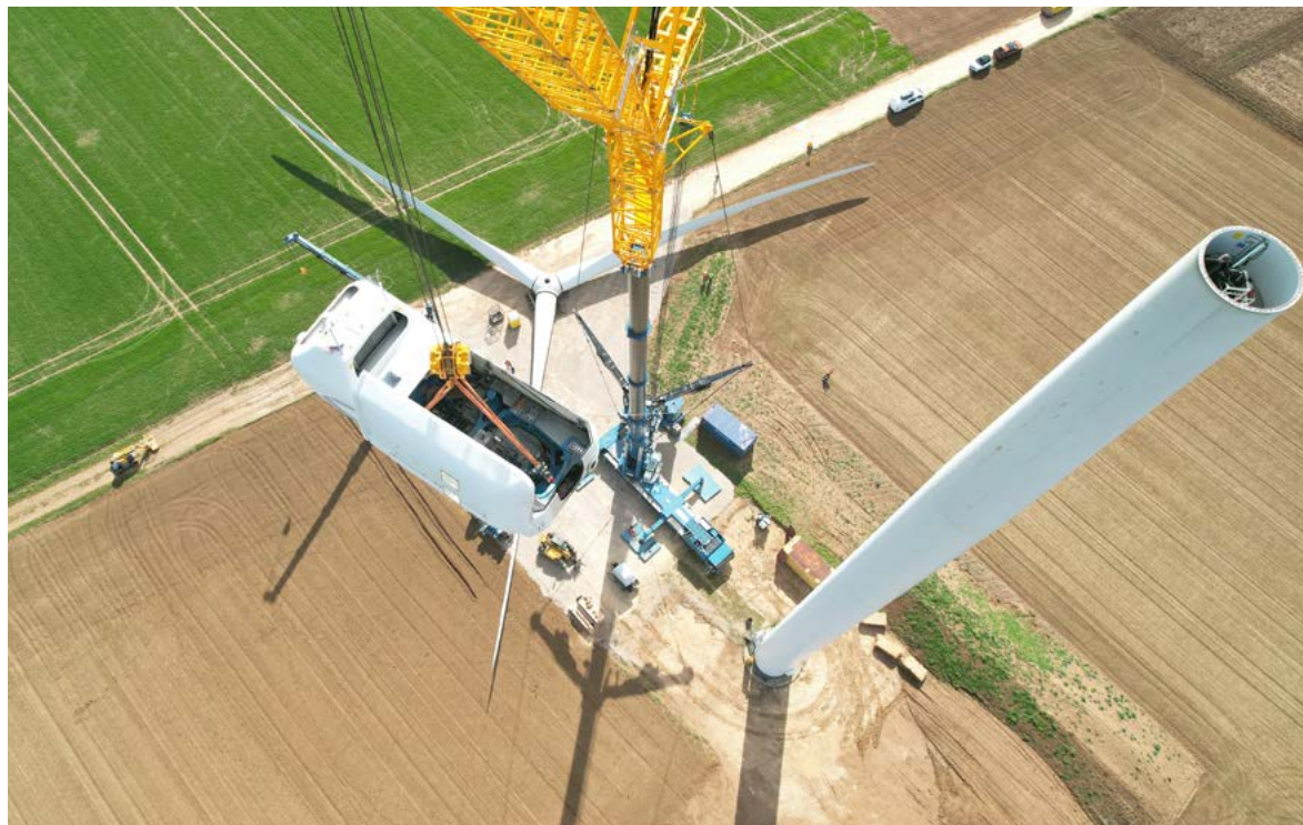
Parc éolien des Hauts de Melleray (28)
