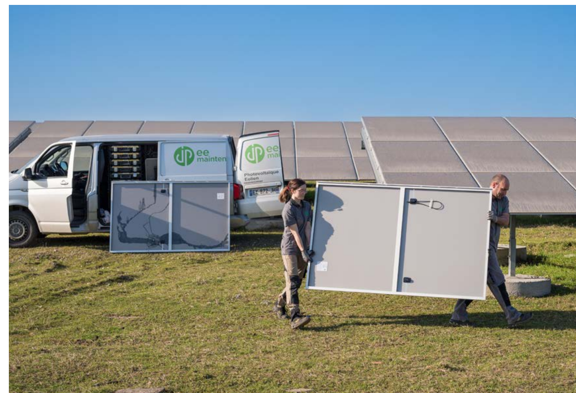
Centrale solaire de Labarde (33)
